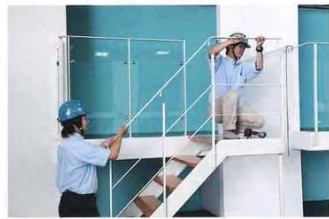
自社工場一度組み立て強度等を事前に検査後、現場で再度組み立てる。施工は1日で完了するので工期にも柔軟に対応できる
